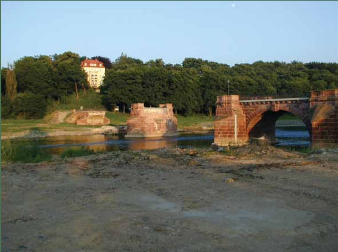
Abb.: Die Pöppelmannbrücke nach der Zerstörung durch das Muldehochwasser 2002
